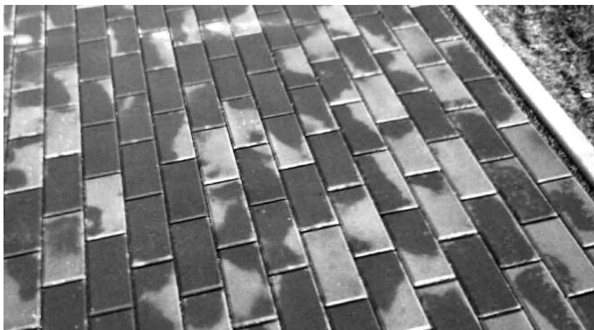
Bei Betonpflasterstreifen, die ein unterschiedliches Abtrocknungsverhalten zeigen, muss nicht zwingend ein Produktmangel vorliegen
