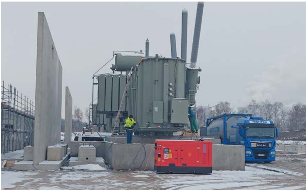
Brandschutzwände für einen Großtrafo im Energiepark Witznitz.
